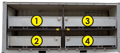
HV Batterie Container Standard mit 4 Behältern
