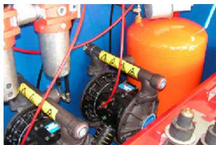
Pumpen und Filter
